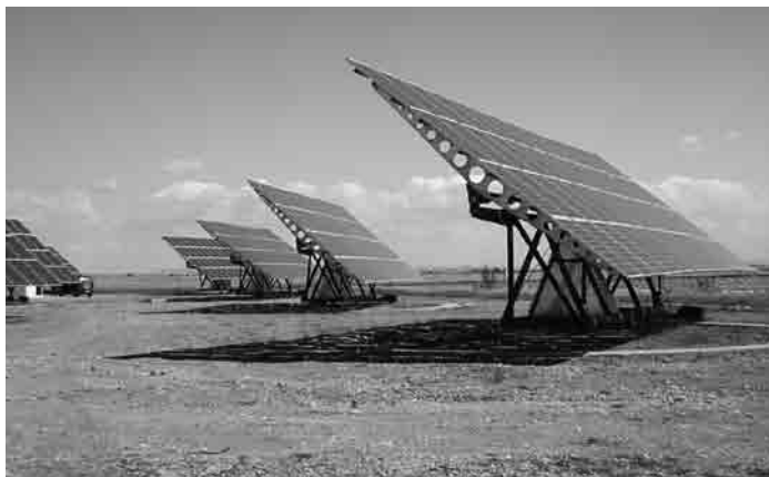
Fotografia: Parc Solar 1MW de potència connectat a mitja tensió.
